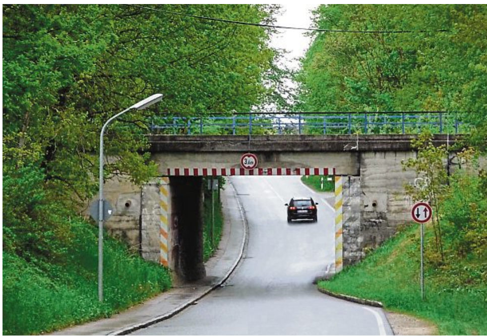
Schwerlastverkehr soll nach dem Willen Höhenkirchen-Siegertsbrunn durch die Bahnunterführung an der Luitpoldstraße passen. Dafür braucht es eine Erweiterung. Die Gemeinde Hohenbrunn ist mit Blick auf eine mögliche höhere Lärmbelastung der Anwohner der Luitpoldsiedlung davon wenig begeistert.
