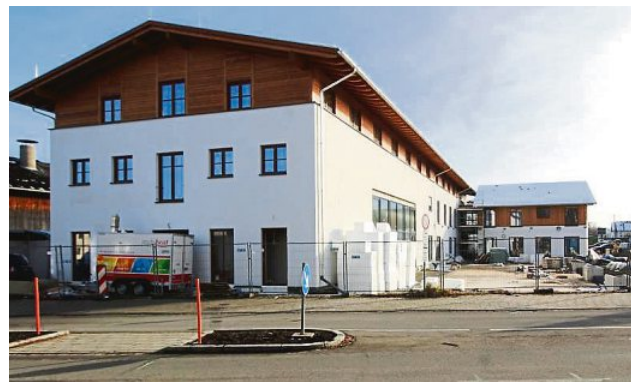
„Millionengrab“ nennt ein Gemeinderat die Baustelle an der ehemaligen Wirtschaft Lutterschmid. FOTO: HETTICH
